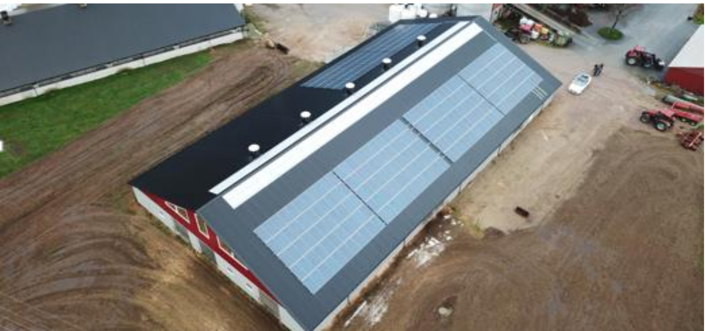
Solceller montert på fjøs
